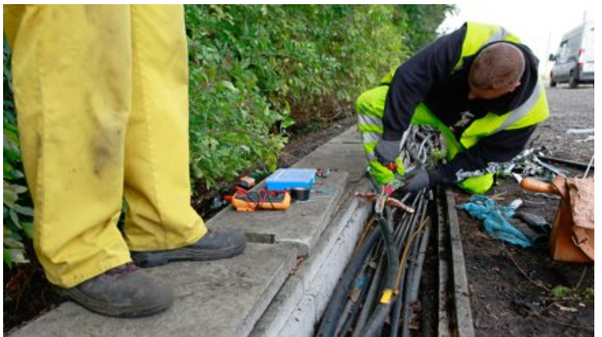
Des ouvriers des chemins de fer réparent des câbles en cuivre le long des voies. Ce métal bon conducteur électrique est souvent volé car il vaut cher.
